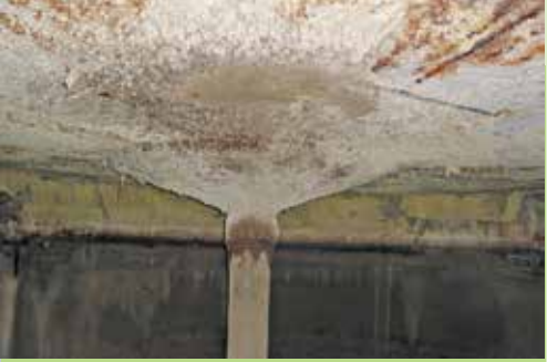
▲ Die Folgen fehlender Betonschutzfolie
