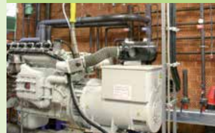
▲ BHKW-Raum mit Schallschutzwand
