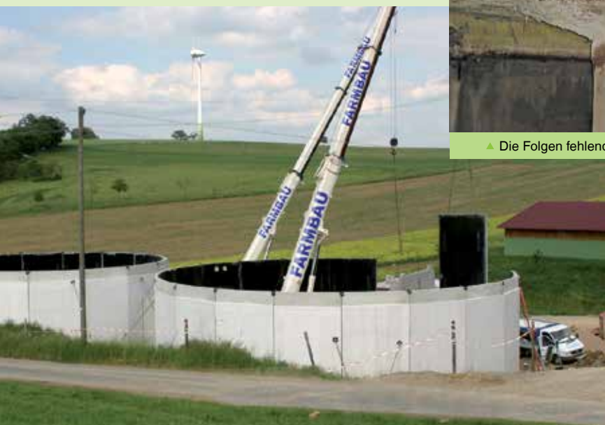
Fermenter mit Betonschutzplatte und Wärmedämmung
